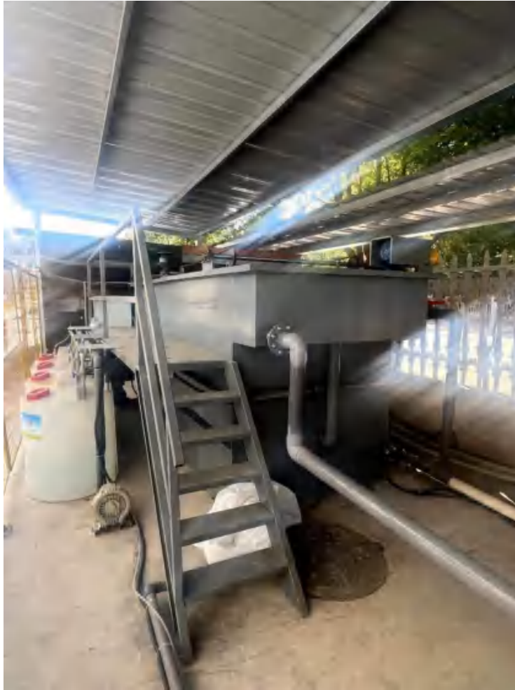
废水处理设备
