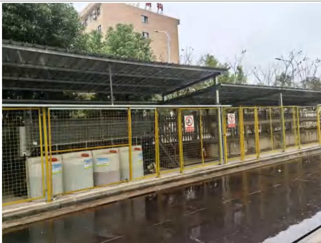
废水处理设备
