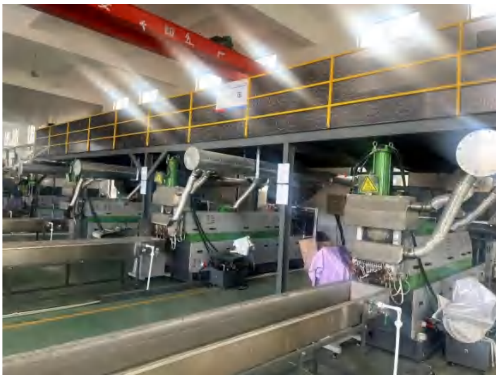
造粒废气收集装置
