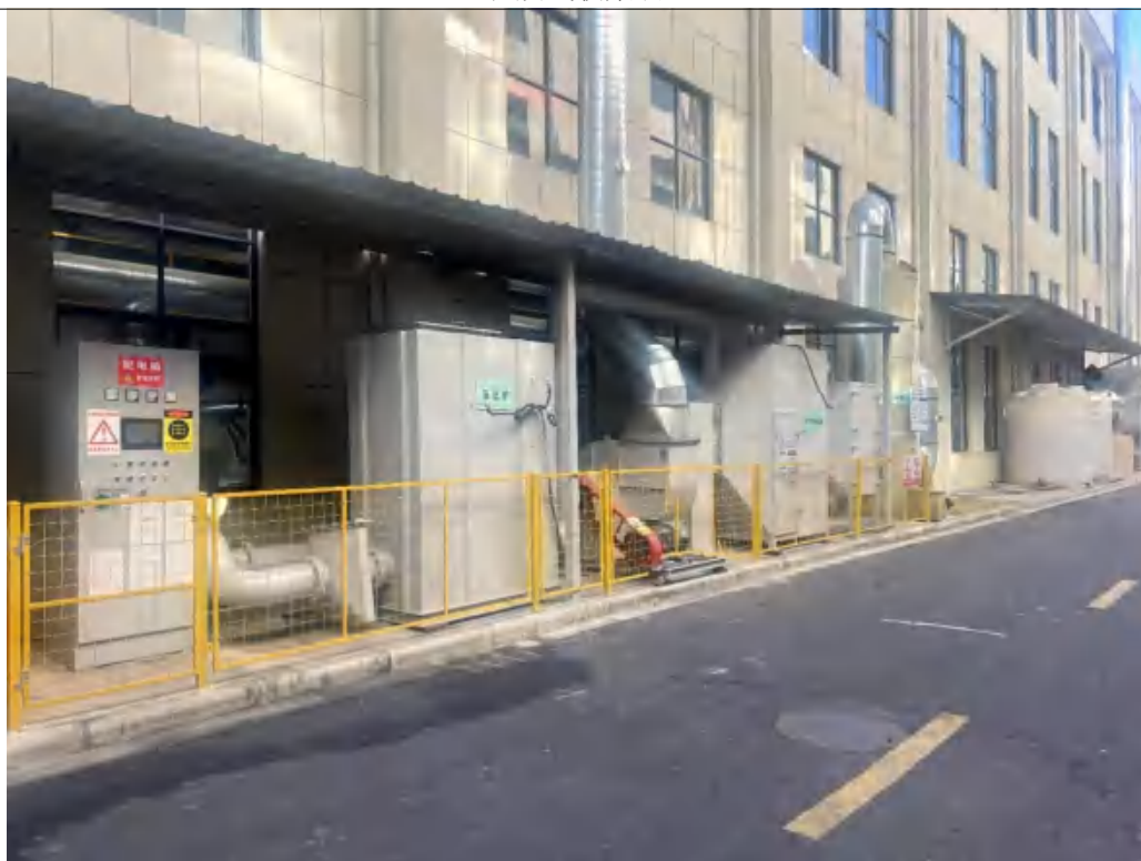
造粒废气处理设施“水喷淋+干式过滤器+活性炭吸附+催化燃烧装置”
